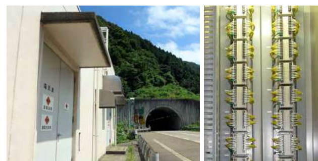
トンネル設備
