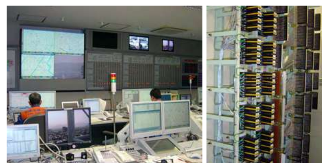
消防指令台システム
