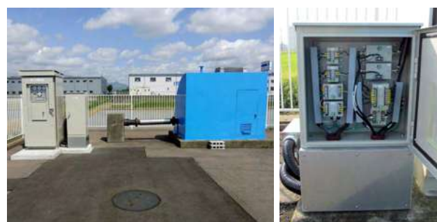
上下水道設備
