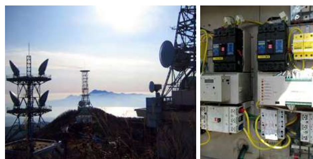
無線中継設備
